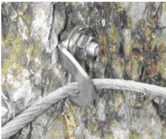
Slika 41: jeklena vrv se dotika stene, neznana varnost sistema, fiksiranje jeklene vrvi na nestandardizirano sidro, ki bo poškodovalo jekleno vrv
